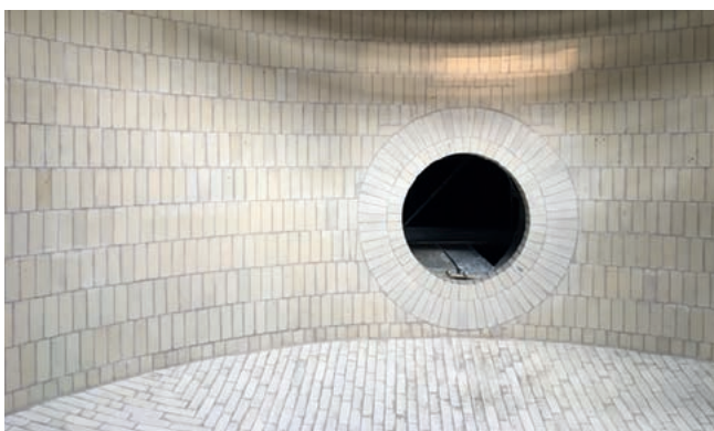
Ausgemauerter Pump Tank in einer Schwefelsäureanlage – Asplit® HB Kitt
